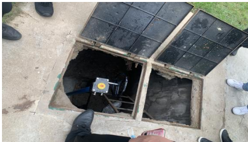
现场雨水排放口截止阀
